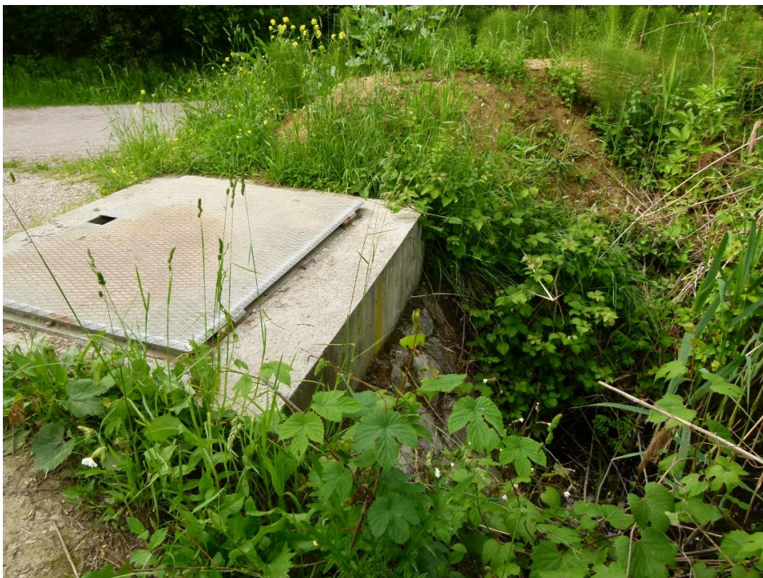
Sl. 32: Dovodna zapornica na Ari – možnost padca ali zdrsa v jarek za zapornico.
